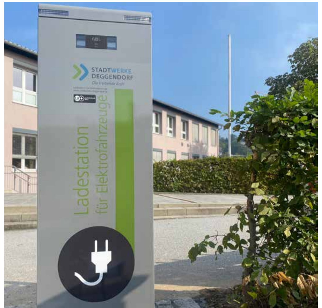
Statt einer stehen am Westlichen Stadtgraben nun acht Ladesäulen zur Verfügung. Dabei handelt es sich um sieben konventionelle Ladesäulen und einen Schnelllader.
