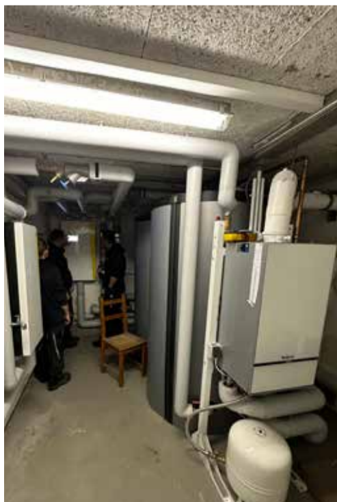
Eine Kombination aus Wärmepumpe und Gastherme ersetzt eine Gaszentralheizung.
